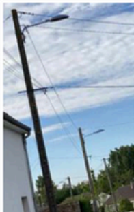
Rue de la Cavée, les nouvelles « gamelles » à led remplacent les anciennes lampes à mercure. L'investissement sera rentabilisé dans 8 ans.
